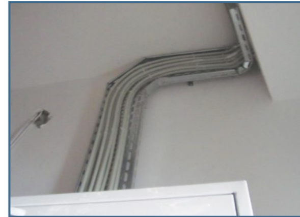
Kablolar bina içerisinde tek bir kanala döşenirler.
